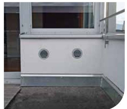
Außen- und Fortluftdurchlässe Zehnder ComfoAir 100 in der Fassade
