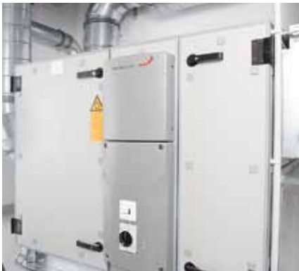
Zehnder ComfoAir 1500 Lüftungsgerät im Keller
