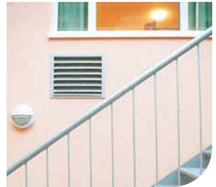
Fortluftöffnung der mechanischen Raumlüftung an der Außenfassade
