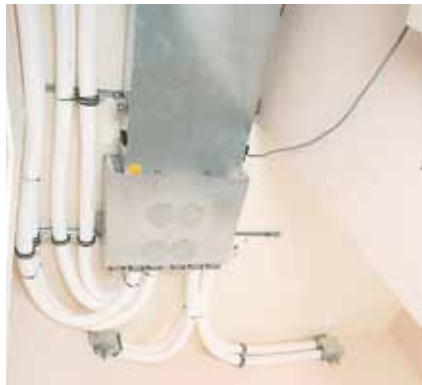
Lüftungsgerät Zehnder ComfoAir 150 innerhalb der später abgehängten Decke im Flur
