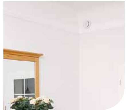
Endmontierter Wand-Luftdurchlass im Wohnzimmer
