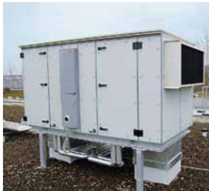
Zehnder ComfoAir 1500 Lüftungsgerät auf dem Dach
