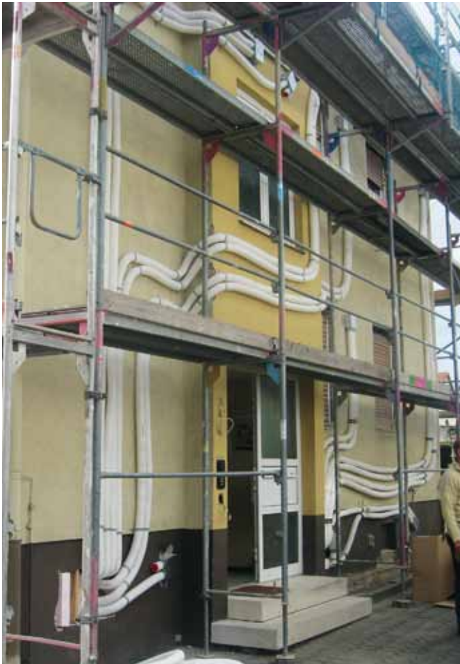
Luftleitungen an der Außenfassade
