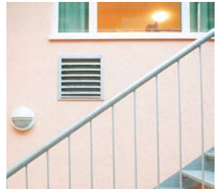
Fortluftöffnung der mechanischen Raumlüftung an der Außenfassade
