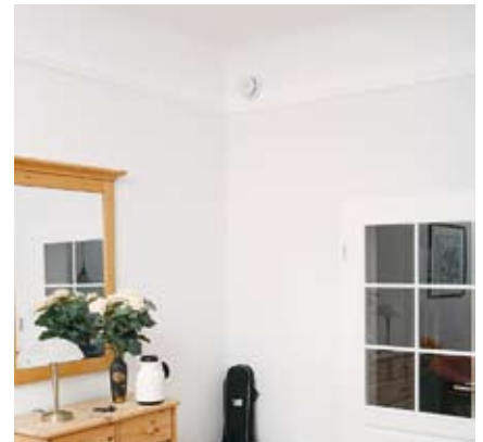
Endmontierter Wand-Luftdurchlass im Wohnzimmer
