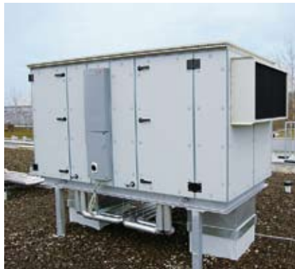
Zehnder ComfoAir 1500 Lüftungsgerät auf dem Dach
