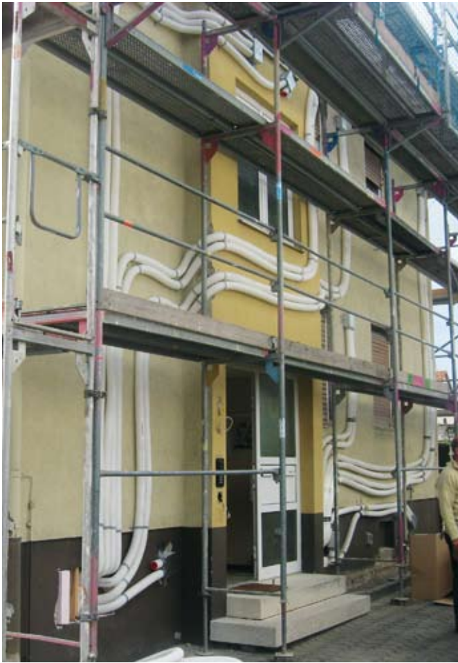
Luftleitungen an der Außenfassade
