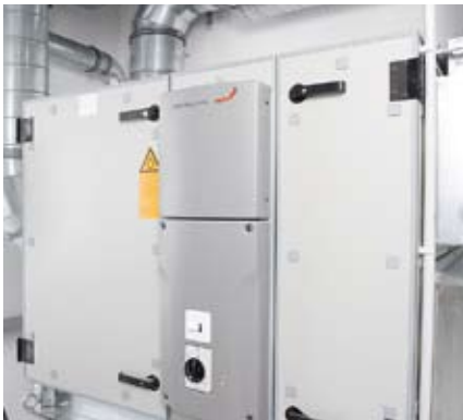
Zehnder ComfoAir 1500 Lüftungsgerät im Keller
